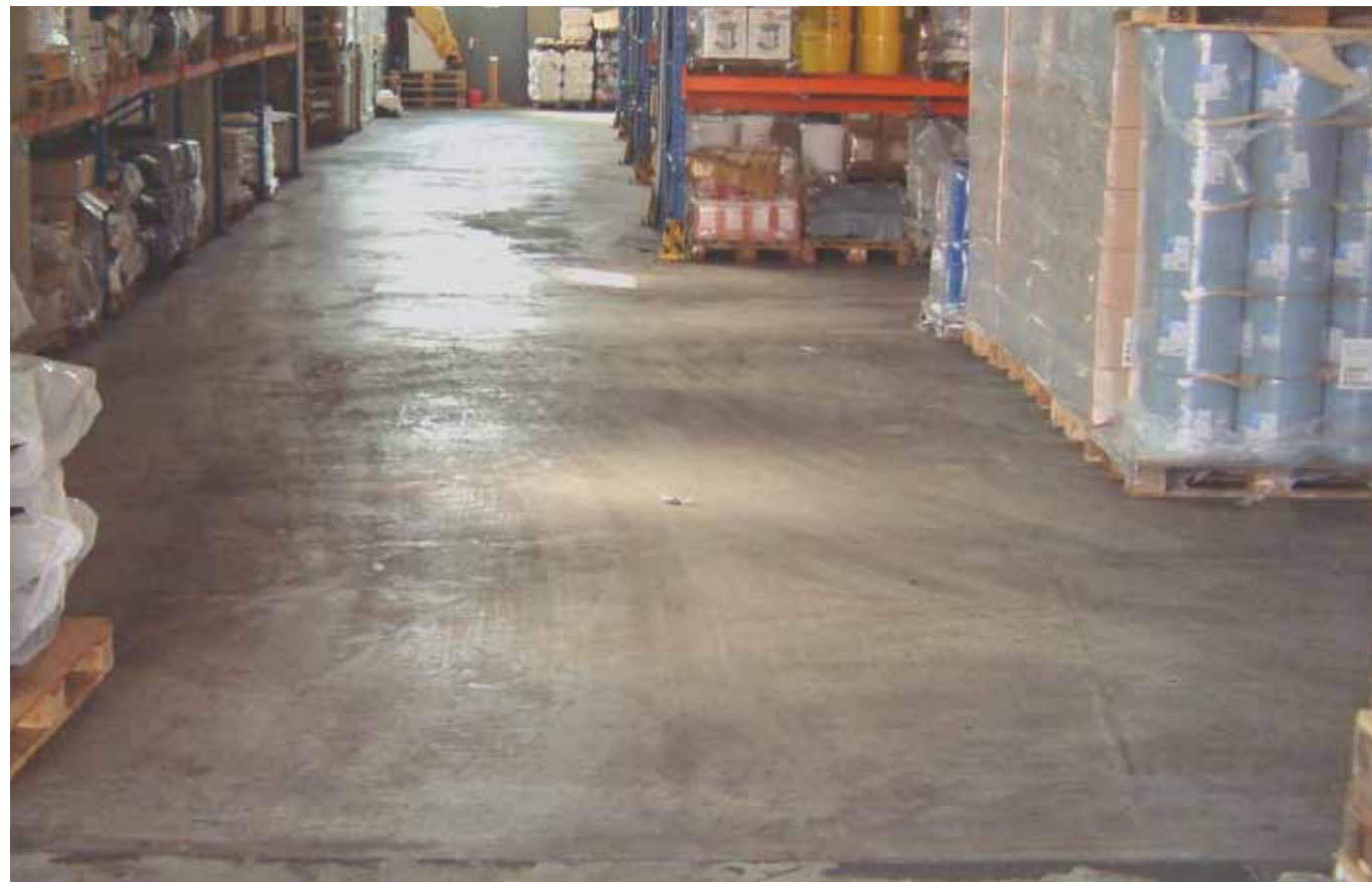
Unbeschichtete Industriehalle nach mehreren Jahren.
